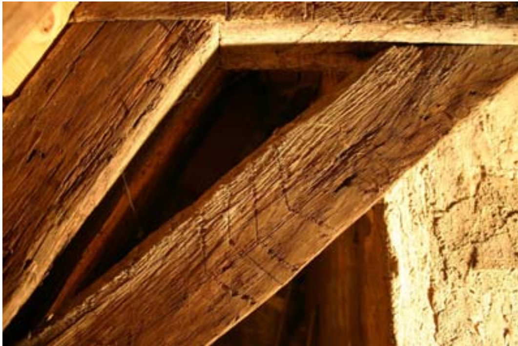
Gekrast en gebroken telmerk <<<< op een korbeel (foto David Derksen/ BMA).
