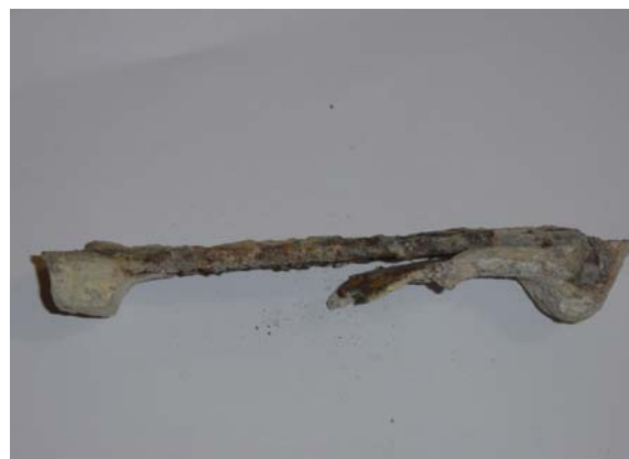
Fig. 31: Corrosie van anker (Sint-Martinusbasiliek in Halle).
