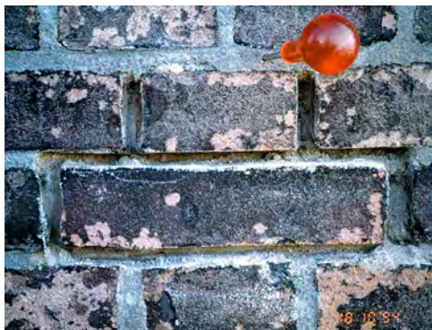
Figuur 28 Zwak, aangetast traskalkvoegwerk. © TNO Bouw
