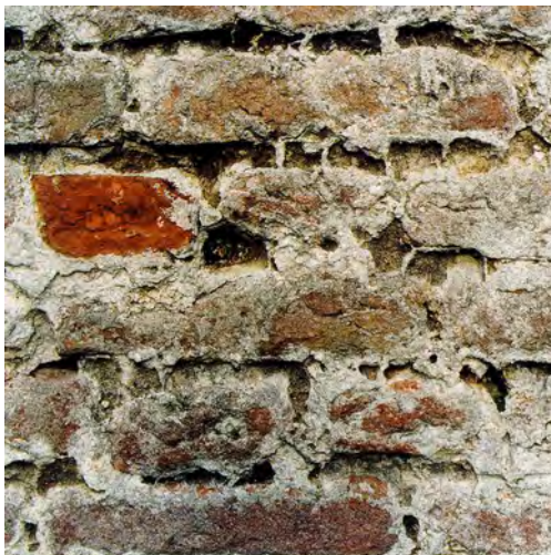
Figuur 27 Detail van de geërodeerde kalkmortel van een oude stadsmuur. © TNO Bouw
