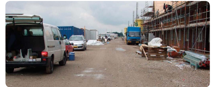
Voorbeeld van een goed begaanbare bouwweg. Bron: TBB/Weerverletbestrijding
