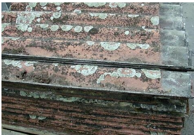
Figuur 8: asbesthoudende golfplaten
