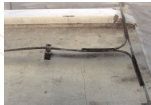
Koperhoudend water versnelt de verwerking van zink. De foto toont de aantasting door het water dat van de koperen bliksemafleider af komt. (foto K. Boeder)
