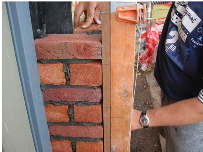
Figuur 4. Metselprofiel op 2cm van het metselwerk om doorstrijken achter het profiel mogelijk te maken.
