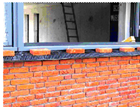
Figuur 8: Tijdelijke waterslag tegen inregenen in het metselwerk.
