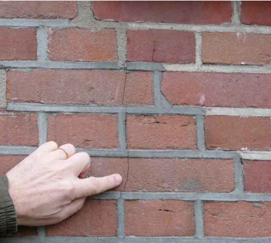
11 Een van de vele scheuren in de gevel van de Beurs van Berlage.
