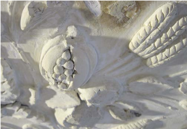
Zeer kwetsbaar stucwerk met schade aan ornamenten die aan het licht zijn gekomen
