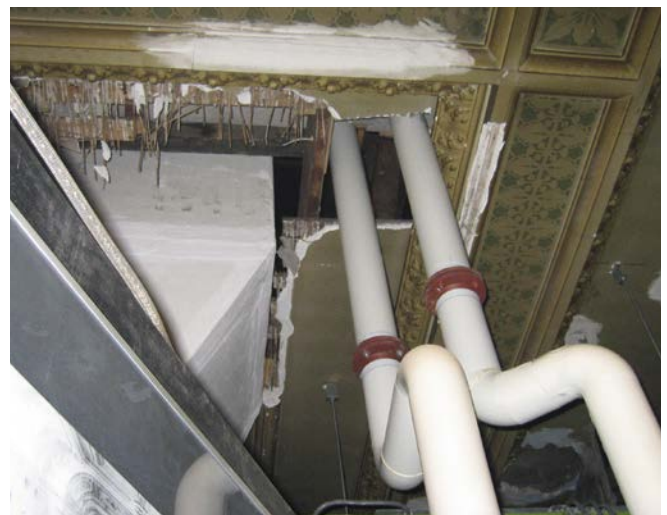
Dwars door het stucplafond met sjabloonschilderingen zijn installaties aangelegd
