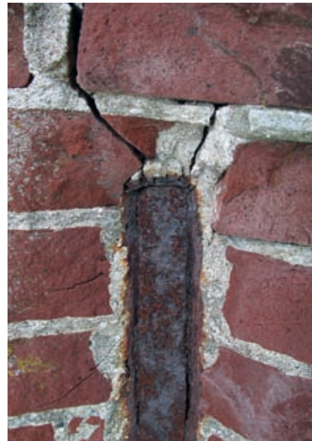
Het roesten van het ijzeren anker gaat gepaard met een aanzienlijke volumevergroting, waardoor het metselwerk uit elkaar wordt gedrukt
