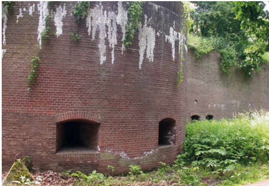
Grote delen van het metselwerk van het reduit van fort Vechten zijn in het verleden ingeboet. Door met name thermische werking zijn deze vernieuwde delen weer losgescheurd van het oude werk
