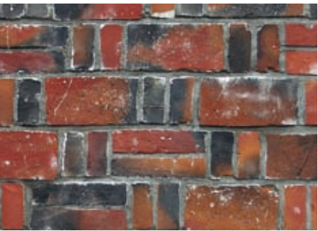
Metselwerk in kruisverband. De craquelé in het voegwerk blijkt geen probleem te vormen
