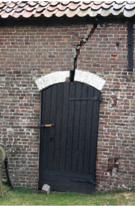
Verzakking van de fundering heeft tot forse scheurvorming geleid op een van de kwetsbare plekken van een gebouw, boven de deur
