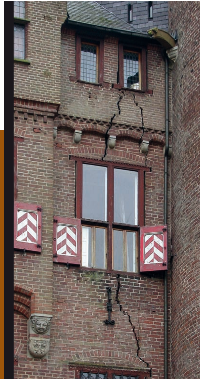
Door funderingsproblemen zijn bij Kasteel De Haar bij Haarzuilens grote scheuren in het metselwerk ontstaan. Diverse soorten onderzoek en ingrijpende maatregelen waren nodig om het metselwerk te stabiliseren en te herstellen
