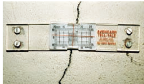
Scheurmeter, waarmee de verdraaiing en verschuiving van twee muurdelen ten opzichte van elkaar zichtbaar kunnen worden gemaakt
