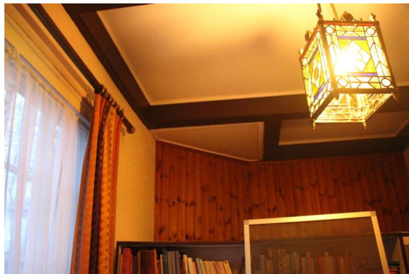
219. Plafond kleine kamer met raveling voor verdwenen stookplaats.
