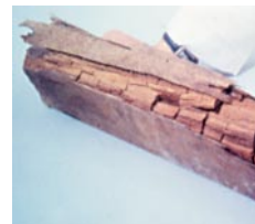
Schade door kelderzwam
