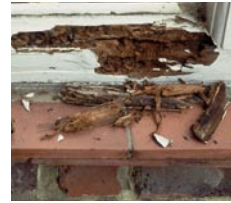
Aangetast kozijnhout door witrotschimmel
