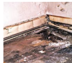
Schade door huiszwam
