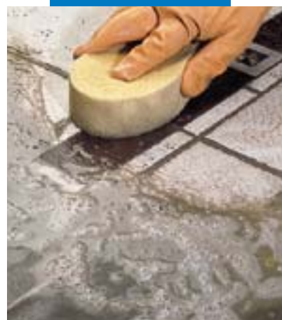
Gebruik van een spons bij het afwerken van een vloer van keramische tegels met houtinleg
