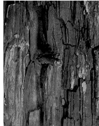
Afbeelding: vergevorderde aantasting door de plaatjeshoutzwam in vuren.
