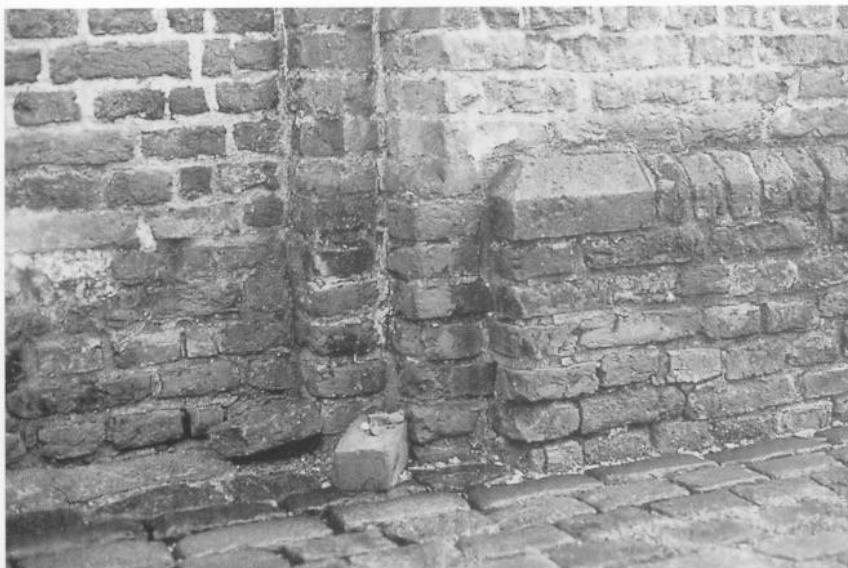
2. Schade door opsplattend water als gevolg van het ontbreken van goten, grind of gras.
