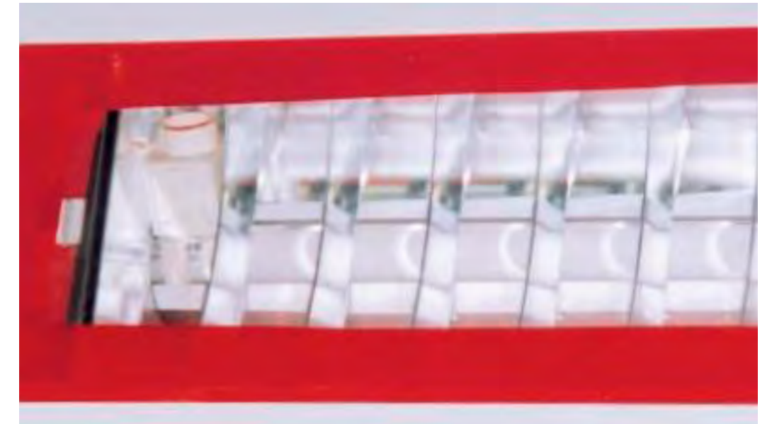
Een sensor in het verlichtingsarmatuur registreert de lichtsterkte in de ruimte. Wanneer deze te laag is gaat de verlichting aan.
