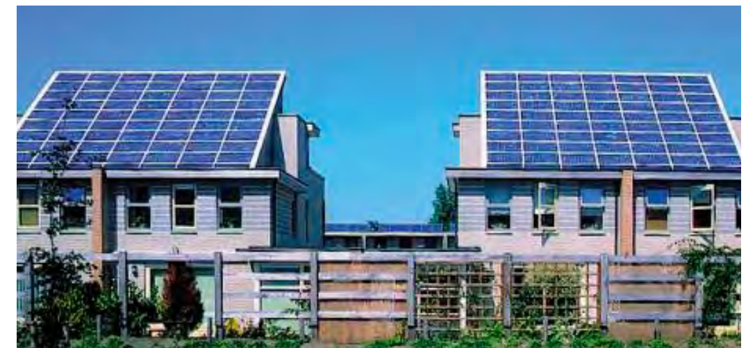
Pv panelen geïntegreerd in het dakvlak.
