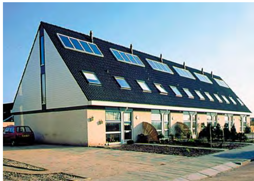
Vlakke plaat collectoren geïntegreerd in het dakvlak.
