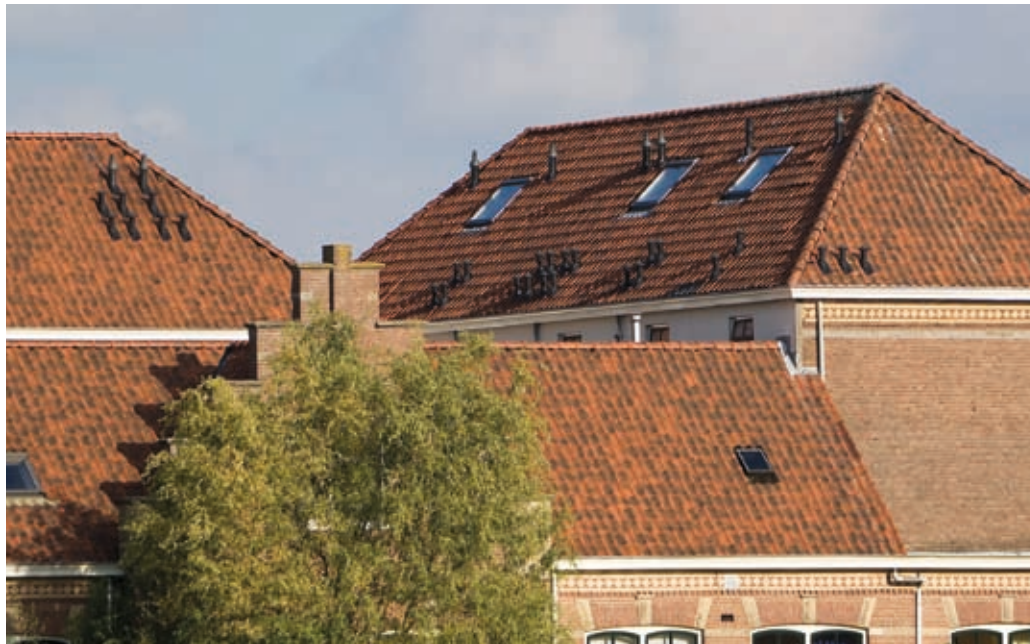
Elk van de appartementen in deze voormalige school in Zutphen heeft zijn eigen afvoerkanaal. Een gebundelde afvoer zou de voorkeur hebben verdiend boven dit woud aan pijpjes. De installatietechniek verzwakt de beleving van het binnenstedelijke daklandschap
