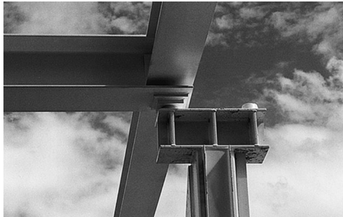
7. Principedetail van een kantelnok. Bij brand vervormt de ligger en kantelt van de console af. Hierdoor wordt omtrekken van de wand voorkomen.
