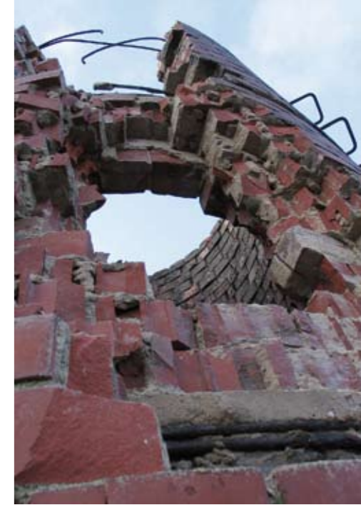
Gevolgen van blikseminslag bij de Tricotfabriek Willink in Winterswijk, in de schoorsteen uit 1954
