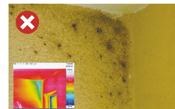
Luchtspouwen tussen het binnenspouwblad en het isolatiemateriaal leiden tot warmteverlies (zichtbaar op de infraroodfoto) en uiteindelijk tot schimmelvorming (zichtbaar op de wand)
