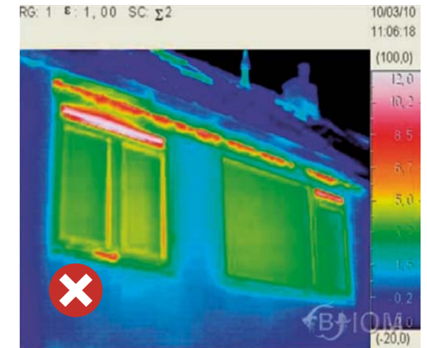
Dakvoet niet goed luchtdicht ingewerkt; warmteverlies zichtbaar op infraroodfoto.
