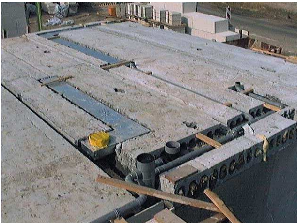
Gebalanceerde ventilatie in combinatie met riolering
