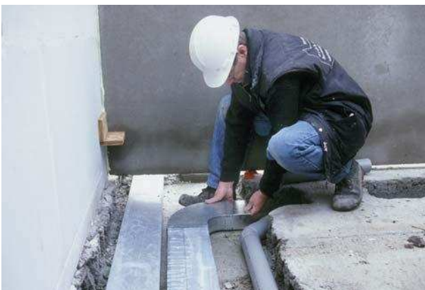
Monteren van de leidingen terwijl de woning al onder de kap is
